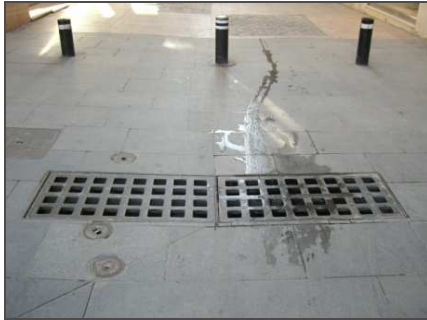
Reixa actual instal·lada al c/ Major.
